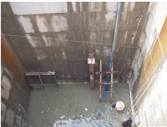
รูปที่ 9 ชั้นส่วนปล่องคอนกรีตเมื่อลงได้ระดับตามต้องการ
