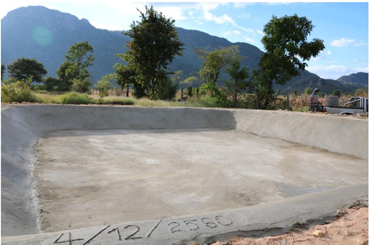
รูปที่ 48 สระกักเก็บน้ำคอนกรีตผสมน้ำยาวพารา
